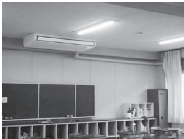
日彰館高校空調機器整備
